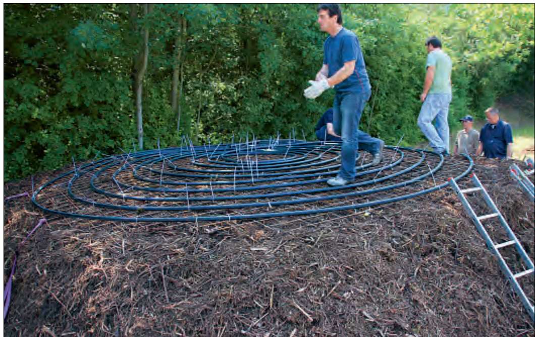
Die handelsüblichen PE-Rohre werden schneckenförmig angelegt und auf einer Stahlmatte befestigt, so dass der Komposthaufen später auch schichtweise wieder abgebaut werden kann.
